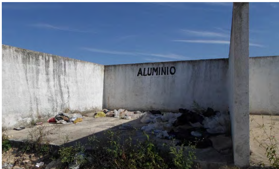
Imagen 38. Celda de separación de residuos en mal estado (aluminio).
