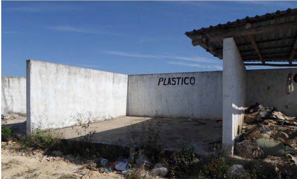
Imagen 39. Celda de separación de residuos en mal estado (plástico).
