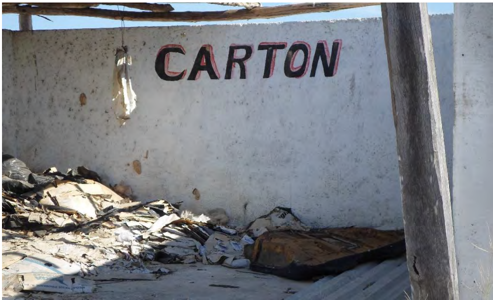
Imagen 40. Celda de separación de residuos en mal estado (cartón).
