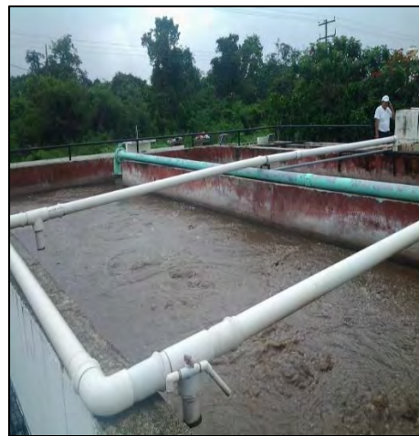
Figura 3.8 Reactor biológico en funcionamiento
