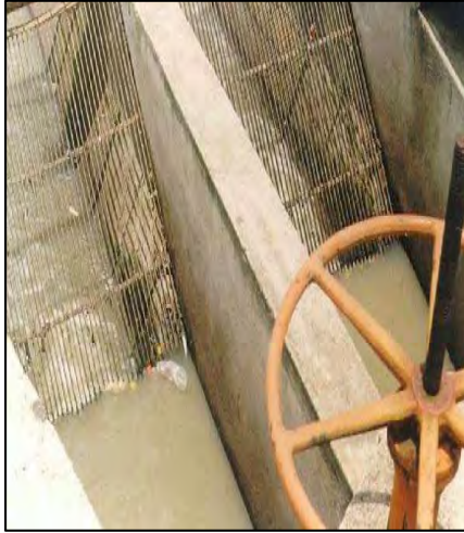
Figura 2.2. Rejillas finas. Fuente: Escalante et al. 2003.
