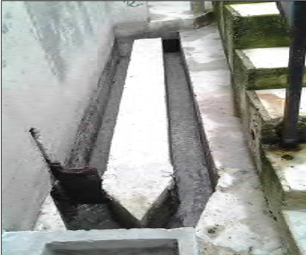
Figura 3.6 Desarenador de la PTAR FOVISSSTE
