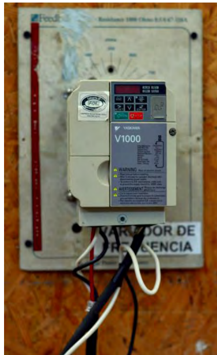
Fig. 3.28 Fijación del variador de velocidad (Yah, 2015).
