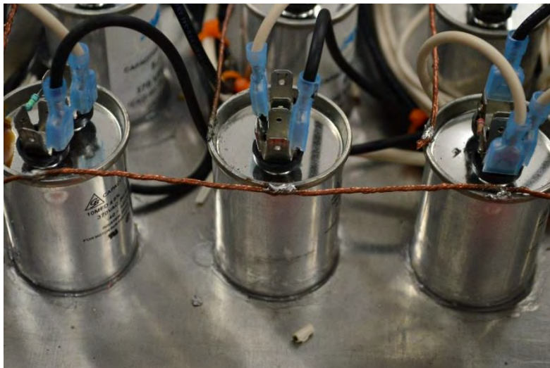
Fig. 3.13 Conductor desnudo uniando todos los capacitores (Yah, 2015).
