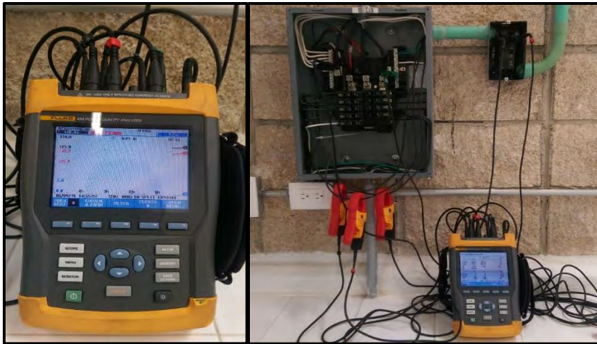
Figura 37. Equipo de medición Fluke 434 en operación.
