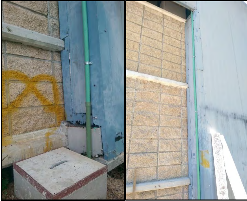
Figura 28. Salida de la canalización del registro eléctrico hacia el tablero de interconexión de CFE.
