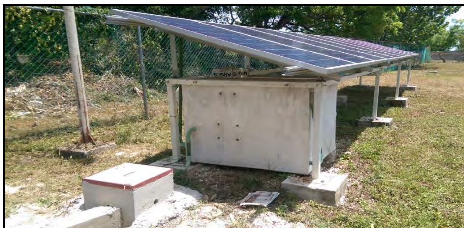
Figura 27. Conexión entre la canalización subterránea y el gabinete del inversor Fronius.
