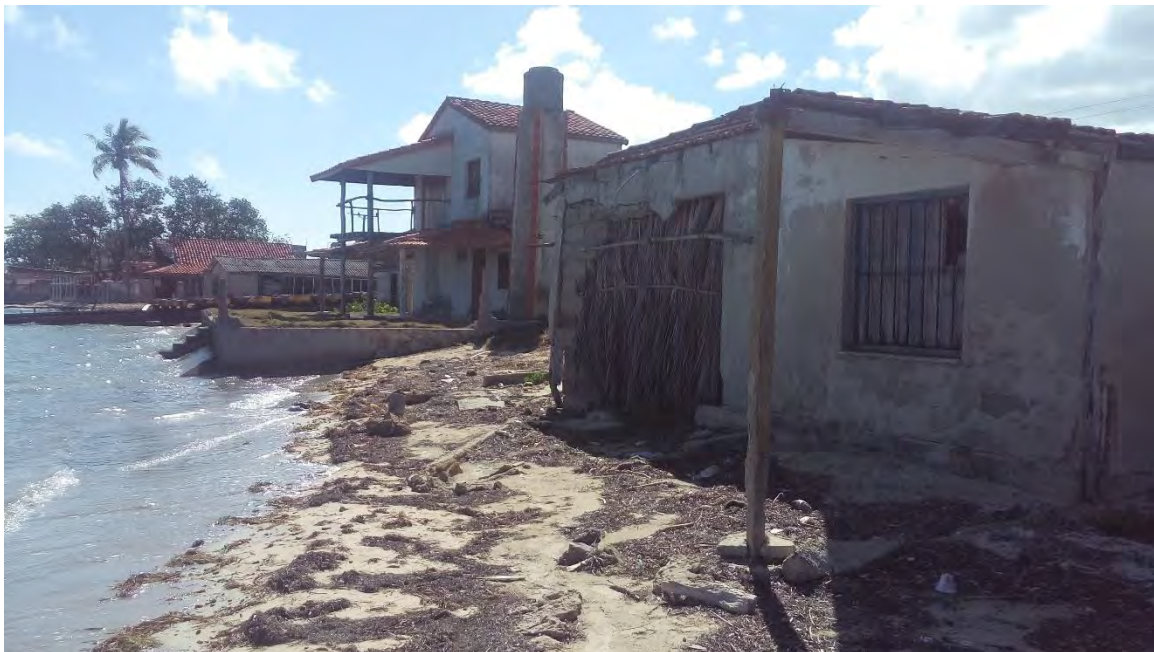
Imagen 13. Casa afectada, casi en derrumbe.
