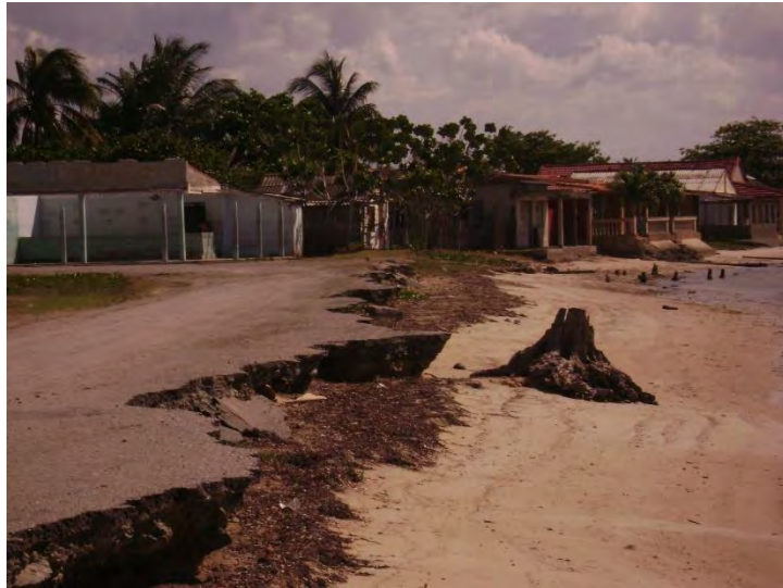
Imagen 14. Porción de carretera afectada por la erosión.
