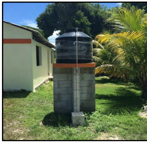
Construcción de la Red de Agua potable, Localidad Raudales, Othón P. Blanco, 2016
