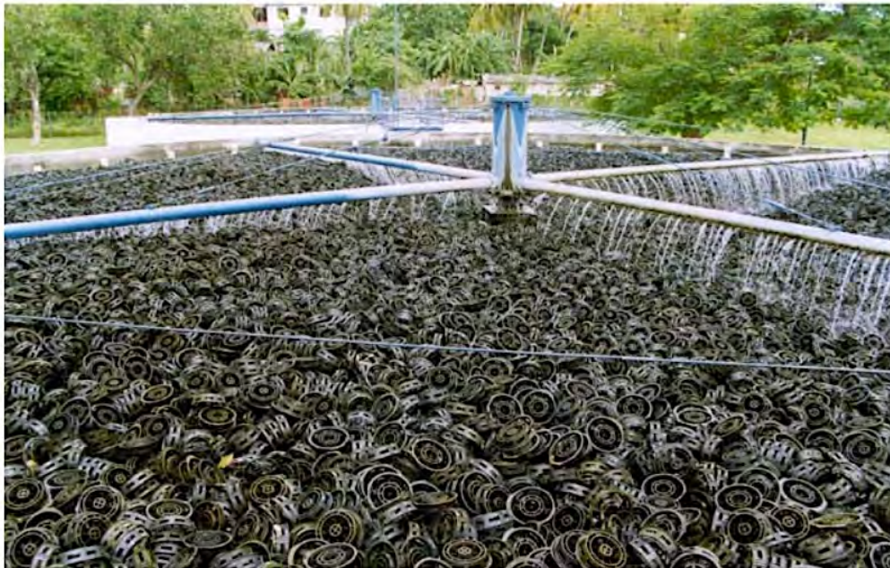
Figura 15 Vista superficial de un filtro percolador con sus empaquetaduras y brazos rociadores (Menéndez, 2005)
