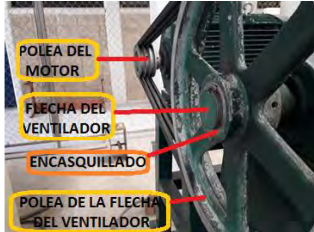
Figura 34. Polea de la Flecha del Ventilador, Encasquillada y Montada.
