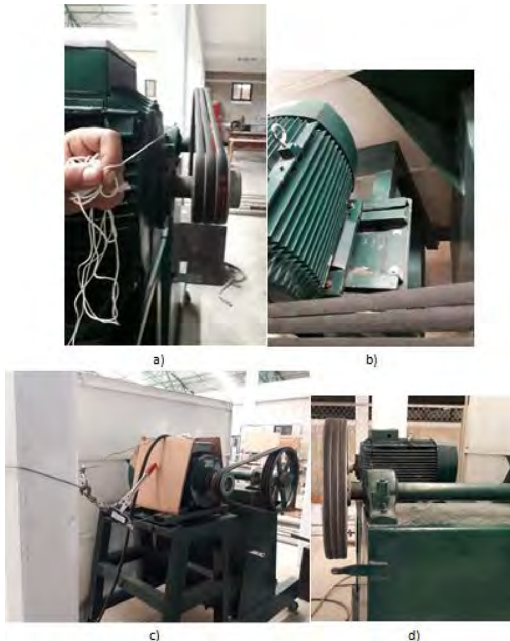
Figura 35. Alineación Entre las Poleas de: la Flecha del Ventilador y la del Motor. a) Se Utilizó una Piola y un Nivel de Medición de 200 cm Para Alinear b) Rieles de la Base Donde se Mueve el Motor. c) Garrucha Utilizada Para Mover el Motor. d) Poleas Finalmente Alineadas.
