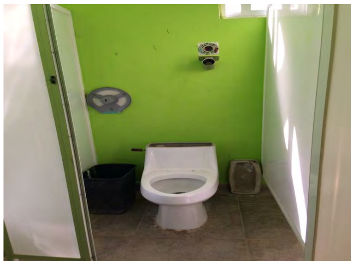
Figura 29. Baño en malas condiciones.
