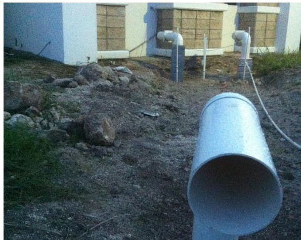
Figura 32. Vista a nivel de piso de EAHE enterrado.
