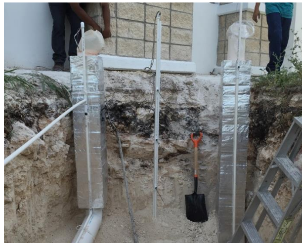
Figura 31. Arreglo de termopares para medir la temperatura del subsuelo a distintas profundidades.
