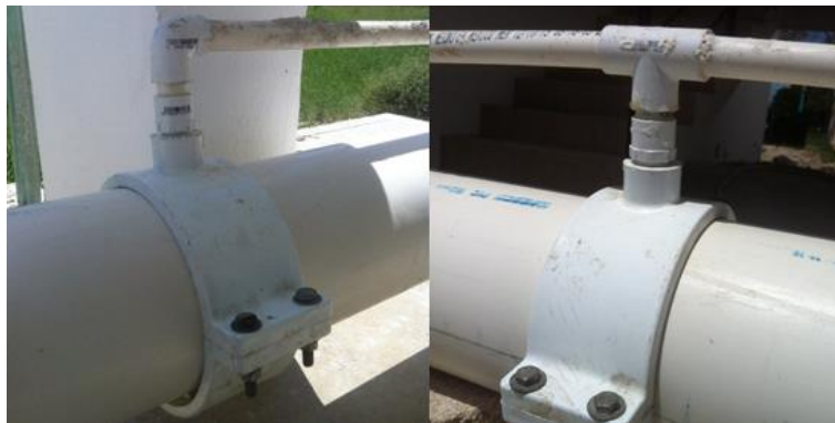
Figura 20. Sistema de medición acoplado a intercambiador de calor tierra air.
