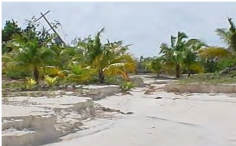
Ilustración 11: Fotografía: Se muestra la generación de un canal de desagüe de aguas contenidas en el interior de la Isla de Holbox y daños a la red de energía eléctrica, destacar la anchura del canal así como su profundidad.
