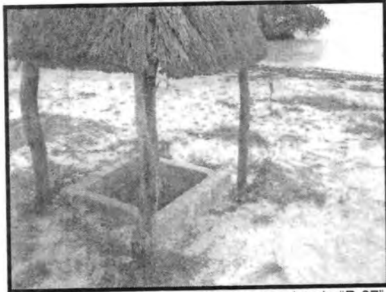
Foto 7. Fuente de abastecimiento nombrado "P-07"
