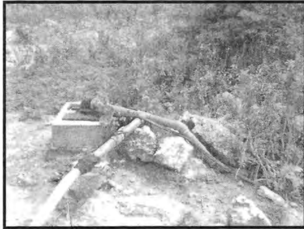
Foto 1. Fuente de abastecimiento nombrado "P-01"
