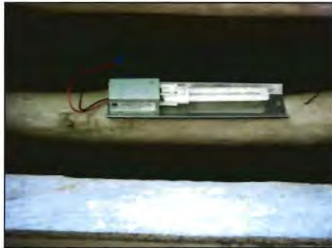
Figura 3.13 Fotografía de una lámpara típica de 13 W Instalada en todas las casas de la comunidad.
