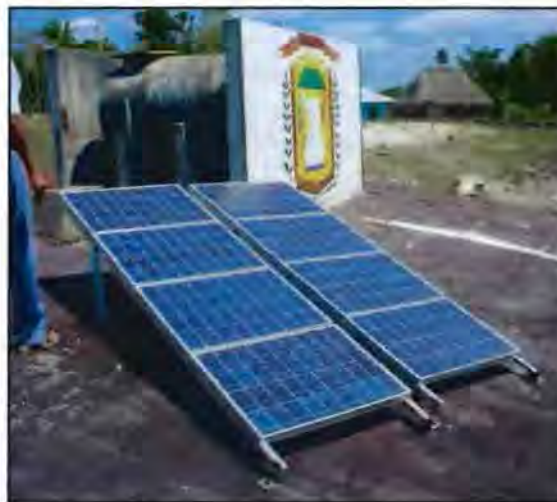
Figura 3.5 Fotografía del arreglo fotovoltaico de la tele secundaria.
