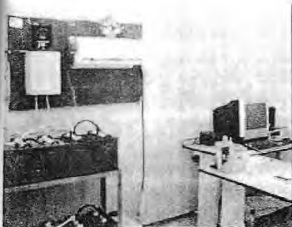
Figura 5. Fotografía en donde se aprecia una parte del banco de baterías y el sistema de control del sistema de la tele-secundaria.
