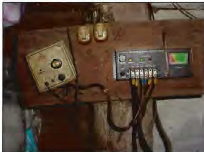
Figura 3.10 Fotografía de un controlador de carga de la marca condumex.
