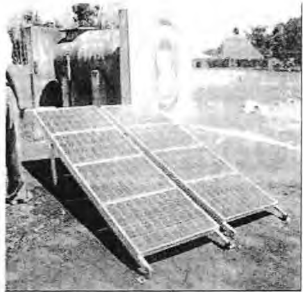
Figura 4. Fotografía del arreglo fotovoltaico de la tele-secundaria
