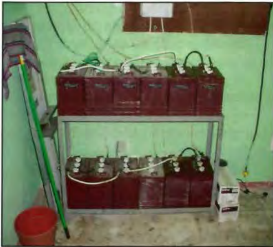
Figura 3.7 Fotografía del banco de baterías de la tele secundaria.
