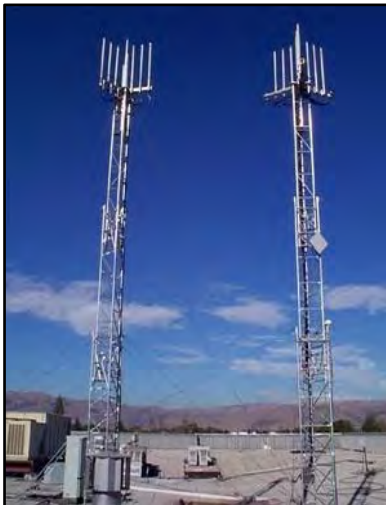
Figura 3.5 Estación base WiMAX (5)
