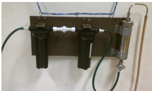
Figura 17. Sistema de filtros.
