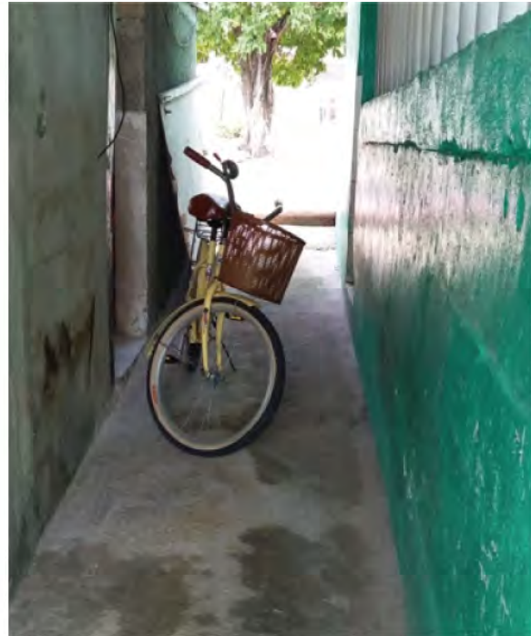
Rampa localizada a un costado del restaurante, no fue pensada para el acceso de personas con discapacidad, mas permite el ingreso de éstas. Clave (IAL 21/ 02-05-15)
