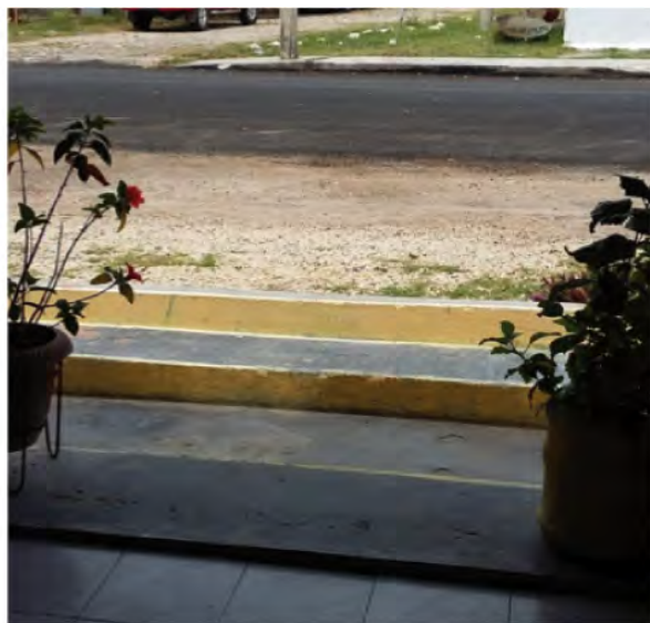
Escalones localizados a la entrada del restaurante dos. Clave (IAL 23/ 02-05-15)
