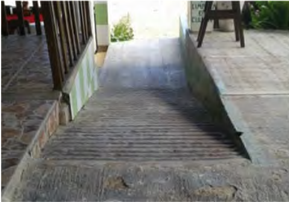
Rampa con una inclinación inadecuada en un restaurante en Calderitas problematizando el acceso a través de ellas. Clave (IAL 08/13-01-15)
