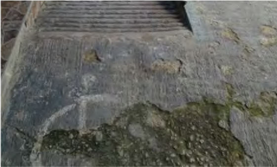
Pavimento deteriorado presentando huecos, lo cual dificulta el tránsito en las instalaciones del restaurant Los Cahuamos . Clave (IAL 03/13-01-15)
