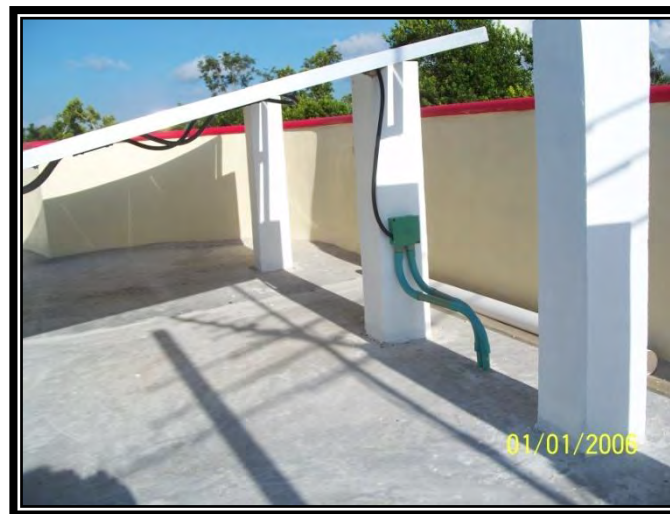
Figura 3.- Fotografía de los módulos fotovoltaicos (caso 1).
