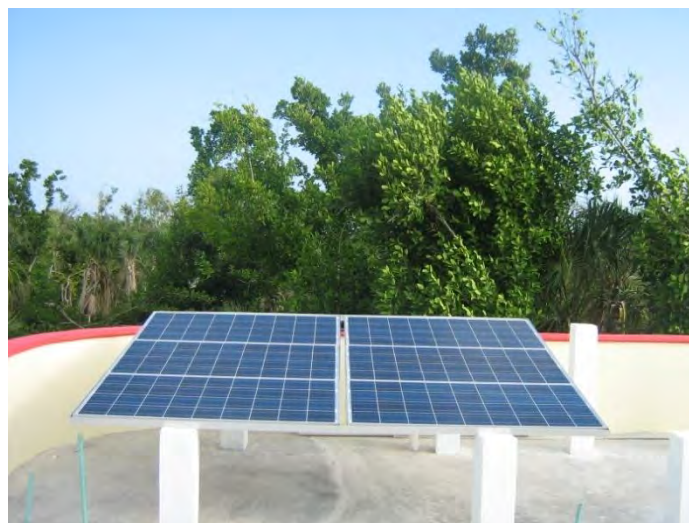
Fotografía de los módulos fotovoltaicos (policristalino de 120 W (Kyocera)).
