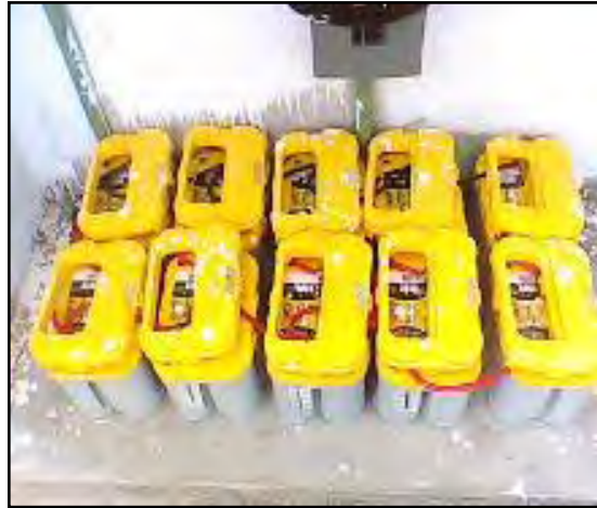
Figura 14.- Banco de baterías (caso 3).
