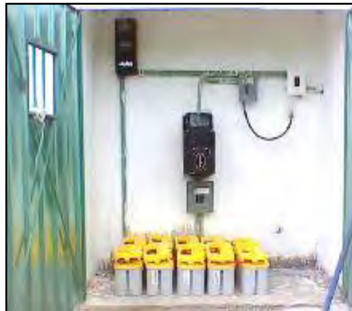
Figura 13.- Fotografía del sistema fotovoltaico (caso 3).
