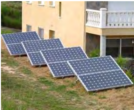
Instalación solar autónoma
