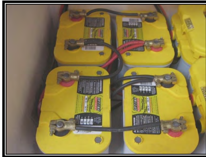
Figura 6.- Fotografía de conexión serie-paralelo del banco de baterías (caso 1).
