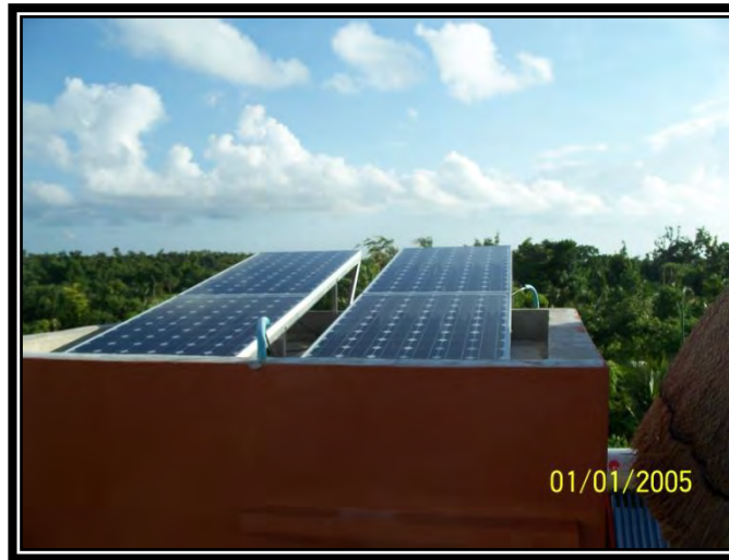
Figura 10.- Fotografía de los módulos fotovoltaicos (caso 2).
