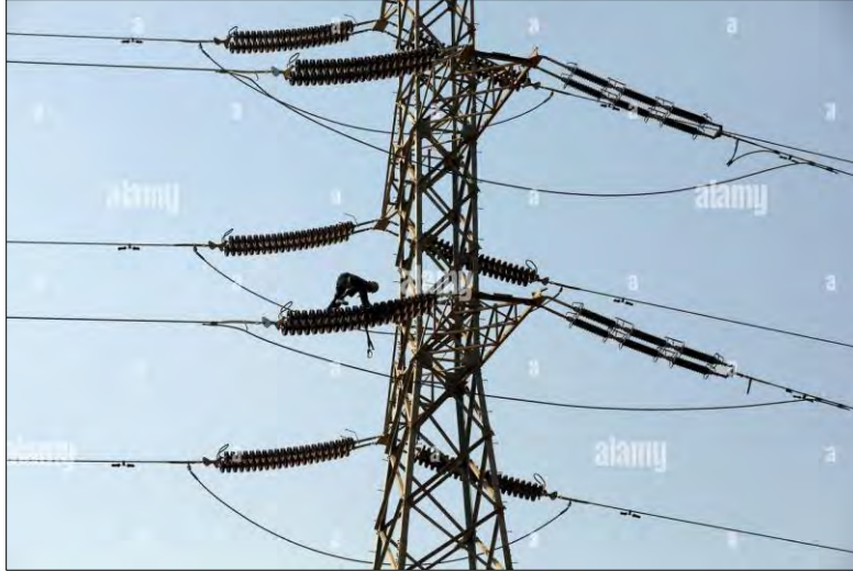
Figura 1.4: Aisladores de porcelana en las torres de transmisión de potencia. Imagen re-editada de la fuente: www.alamy.com
