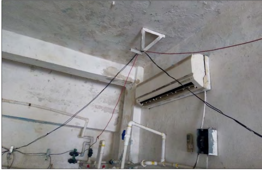
Figura 2.18: Ampliaciones mal diseñadas, los conductores se encuentran colgando sin su debida canalización que los proteja.
