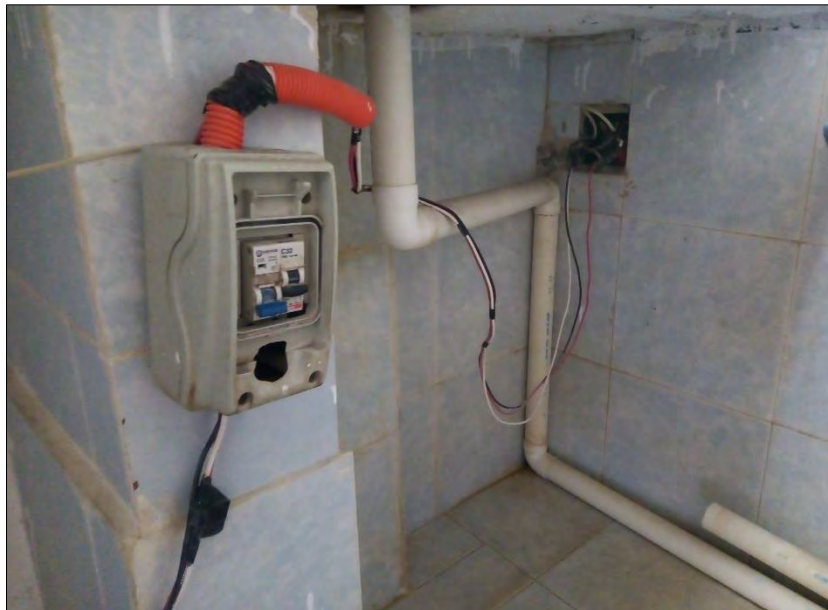
Figura 2.4: Caja de conexiones sin la canalización y accesorios apropiados. Es importante instalar la caja de conexiones en un lugar adecuado para su manipulación.
