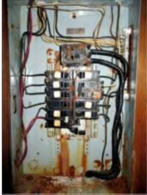
Figura 2.7: Centro de carga degradado de una IE sin mantenimiento. Fuente [6].
