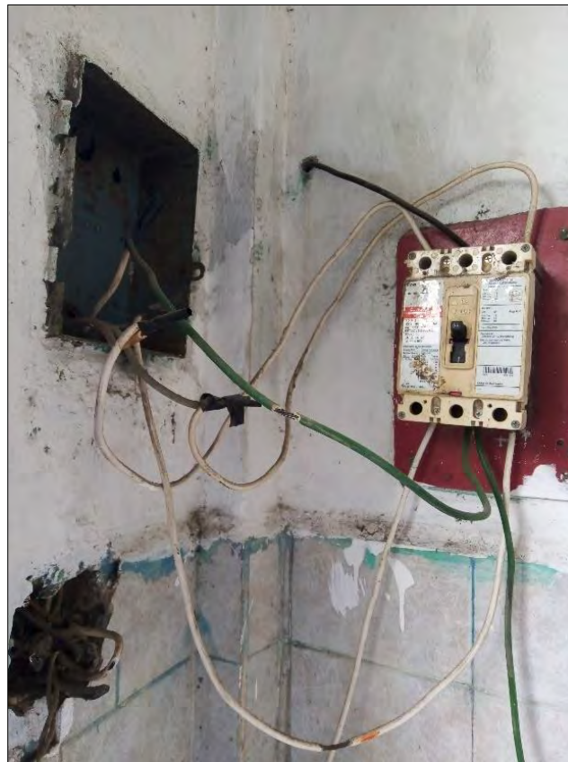
Figura 2.15: Interruptor principal instalado por personal no calificado; no tiene armazón que lo proteja, presenta cables pelados y sin canalización, además el conductor de puesta a tierra está conectado al interruptor lo que pone en riesgo a los usuarios.
