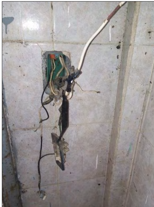
Figura 2.10: Equipo y accesorios eléctricos desgastados. También se puede observar conductores pelados.
