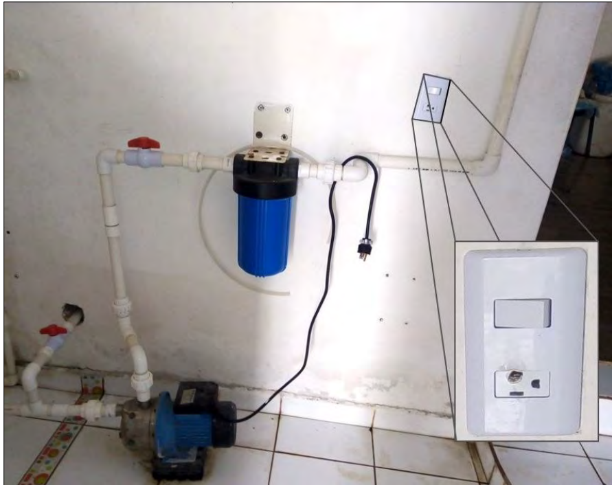
Figura 2.19: Motor conectado a una instalación eléctrica inadecuadamente, se observa sobrecalentamiento en el contacto debido a que no es apto para dicha carga; el motor debería tener su propio circuito y ser controlado por un interruptor termomagnético.
