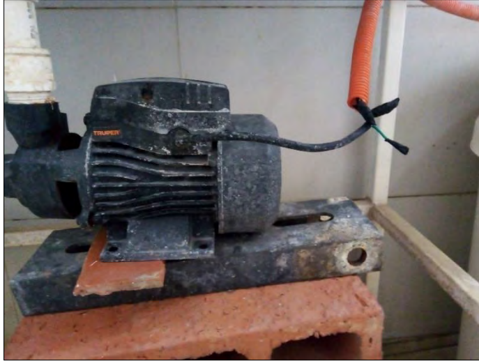
Figura 2.13: Motor no conectado al sistema de puesta a tierra de la instalación eléctrica.
