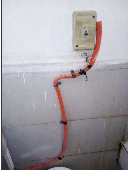
Figura 2.1: Tubería de polietileno no adecuada para uso de forma expuesta.
