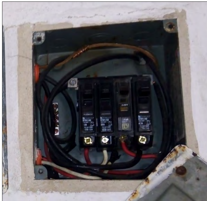
Figura 2.2: Tablero sin los accesorios apropiados para conectar las tuberías.
