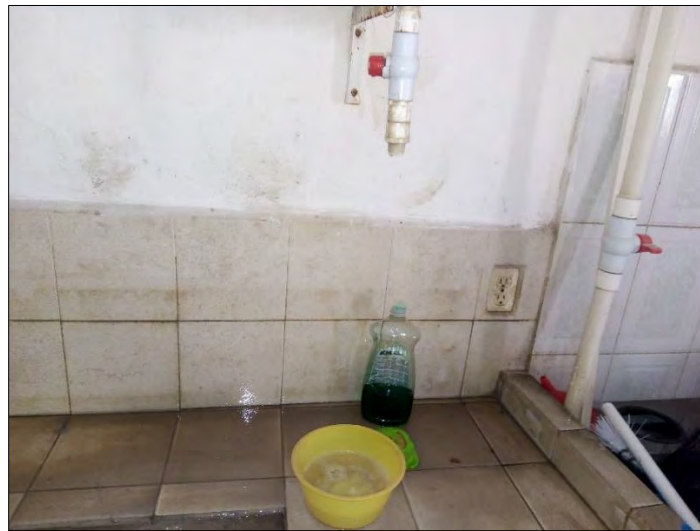
Figura 2.12: Contacto en zona húmeda sin protección de falla a tierra.
