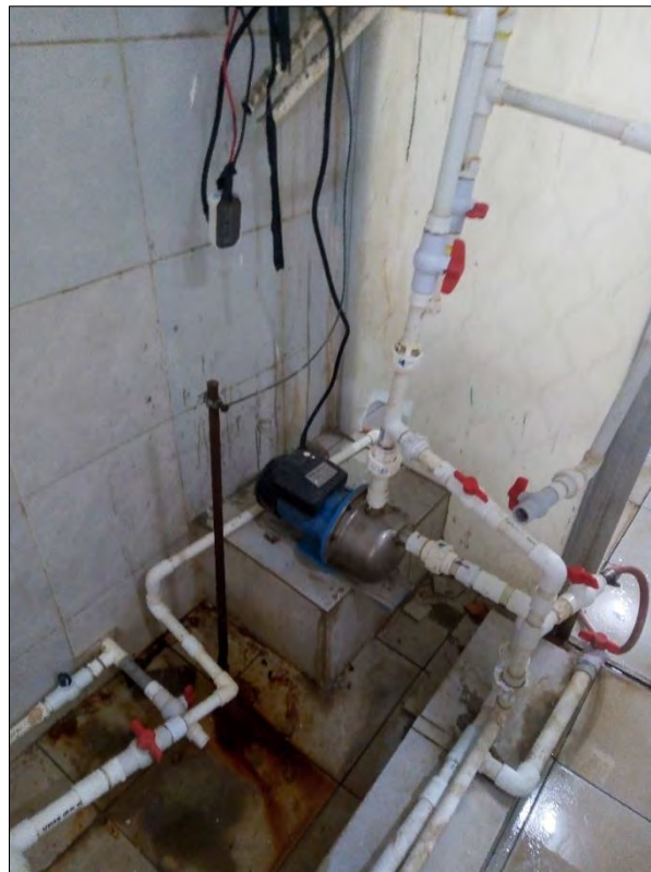
Figura 2.14: Electrodo de puesta a tierra instalado inadecuadamente; la varilla debería estar enterrada completamente, el sistema es independiente, por lo que no está interconectado al sistema de puesta a tierra principal, además es muy probable que no esté comprobado que el valor de la resistencia a tierra sea aceptable.
