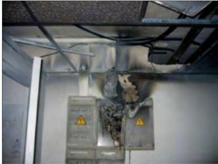
Figura 2.6: Incendio causado por sobrecargas en los circuitos de una IE. Fuente [6].
