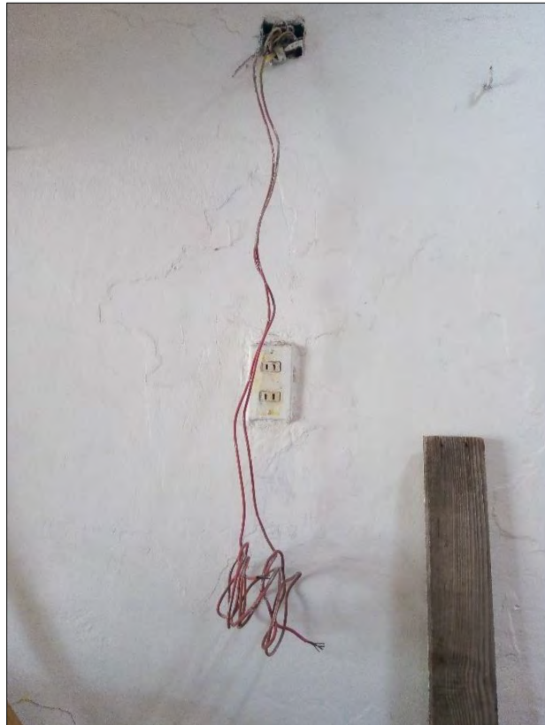
Figura 2.8: En las IE antiguas se puede encontrar con cables sueltos y hasta pelados, incluso contactos obsoletos.
