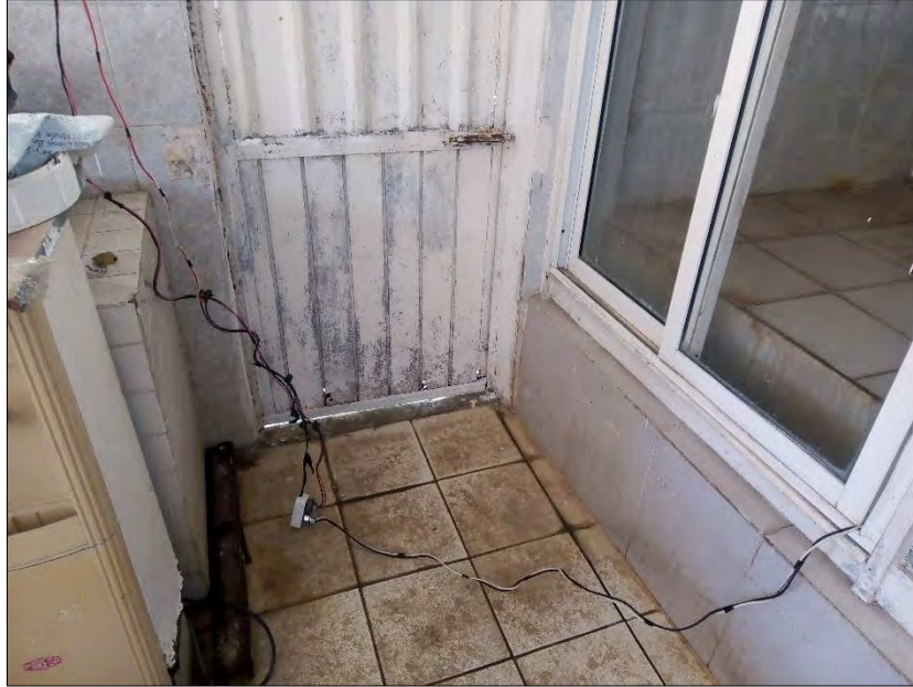
Figura 2.3: Los conductores expuestos en el piso pueden causar accidentes que ponen en riesgo la integridad de las personas y la instalación.
