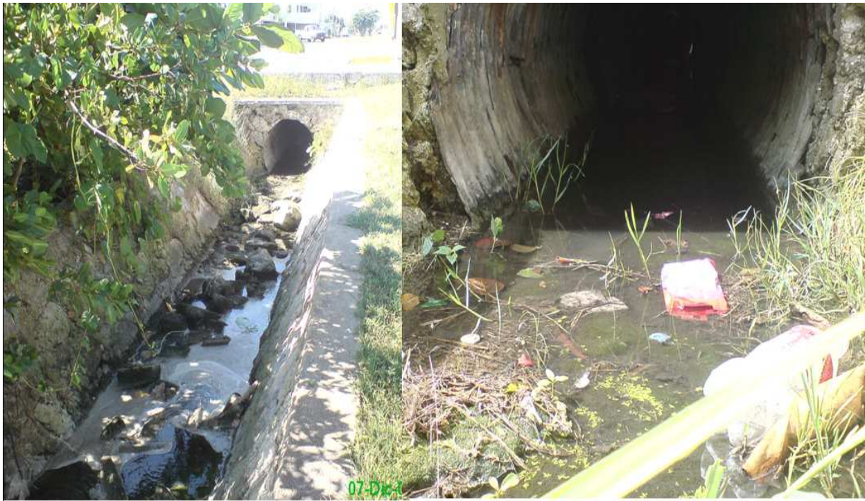
Figura 43. Efluente pluvial de la calle Lázaro Cárdenas.
