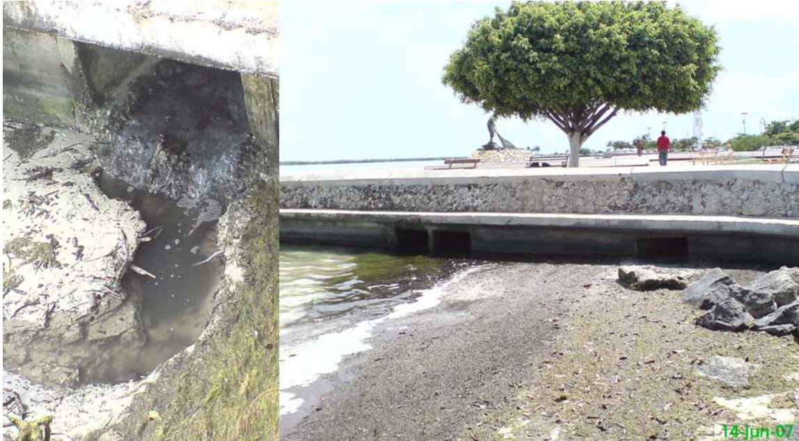
Figura 41. Efluente pluvial de la fuente del pescador.
