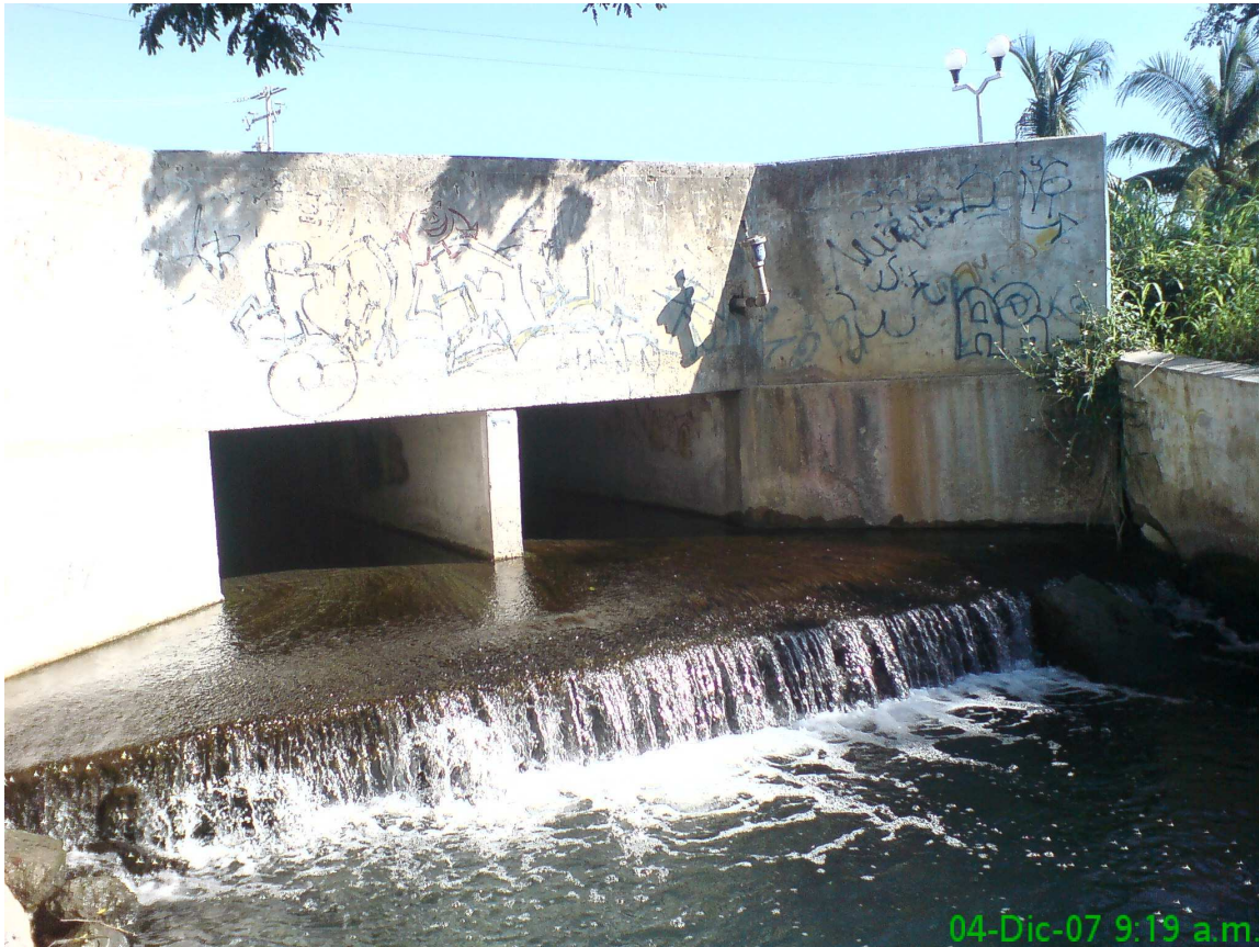
Figura 39. Efluente pluvial de los tanques de almacenamiento.
