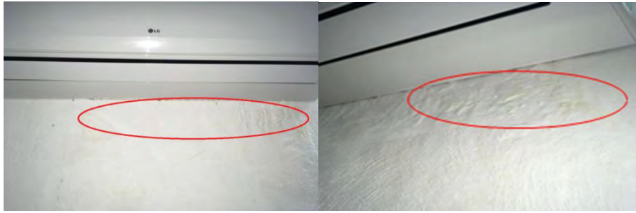
Figura 4.1 Aires acondicionados con leves infiltraciones.
