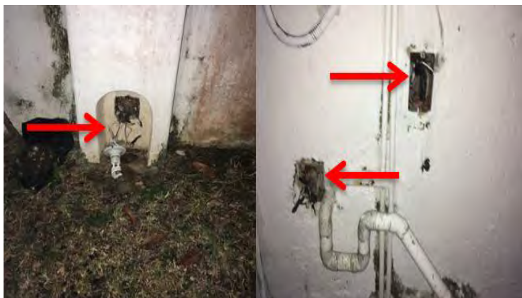
Figura 4.5 Portalámparas colgando, cables expuestos a la intemperie cerca de la tubería de agua.
