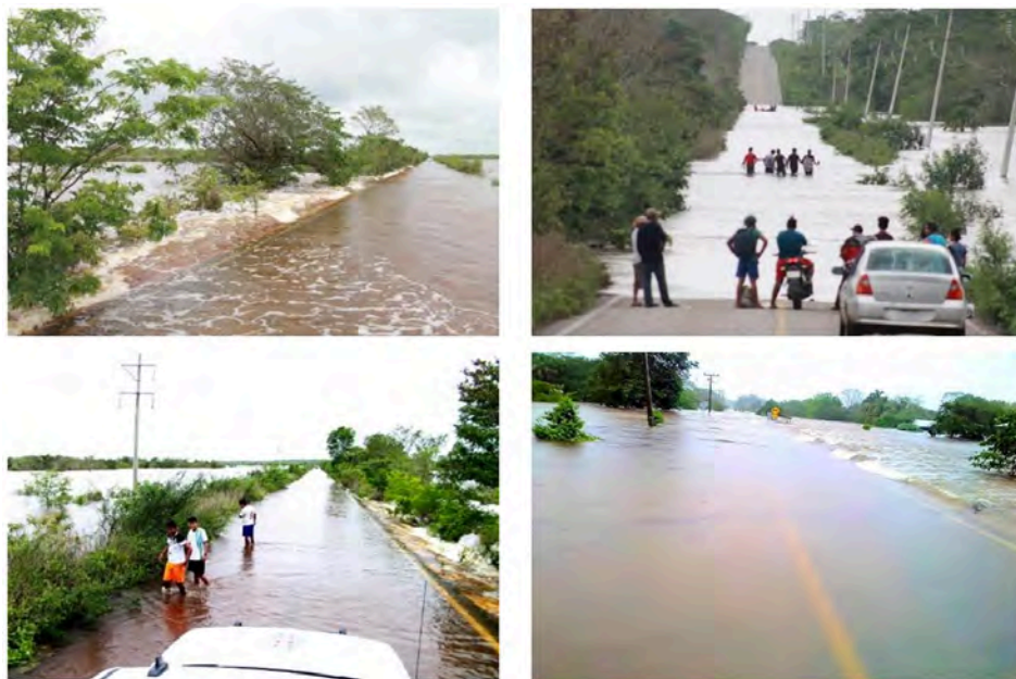
Figura 9. Inundación de la carretera Ucum – Unión
