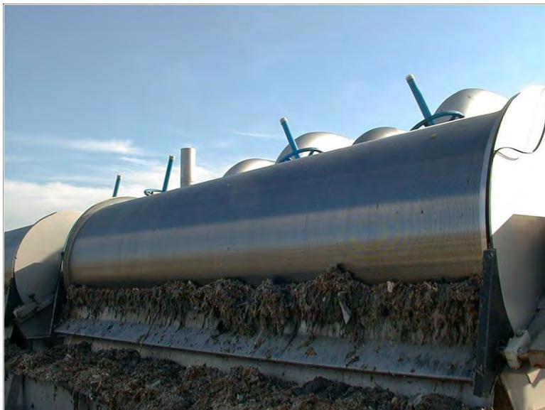
Fig. 2.2 La figura muestra una criba en su parte posterior eliminando los sólidos separados de las aguas residuales.
