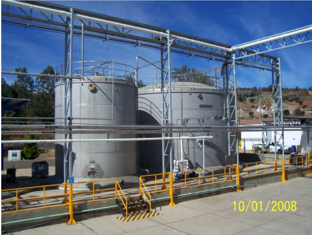
Fig. 4.4 Tanques de reposo de lodos para el biodigestor.
