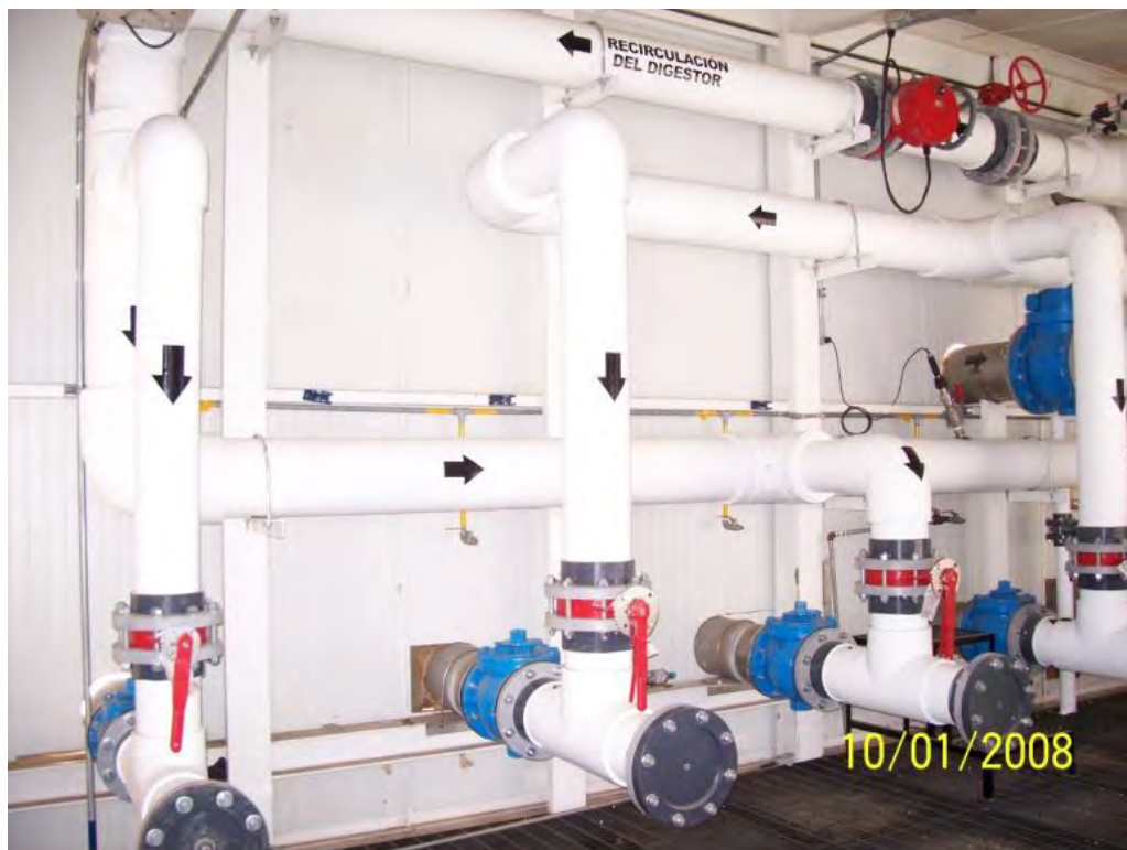
Fig. 4.3 Sistema de recirculación del digester.
