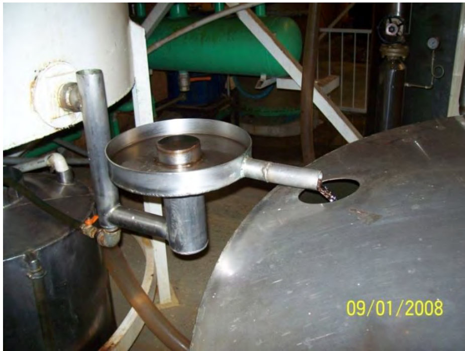
Fig. 1.14 Foto de un tanque de recepción.
